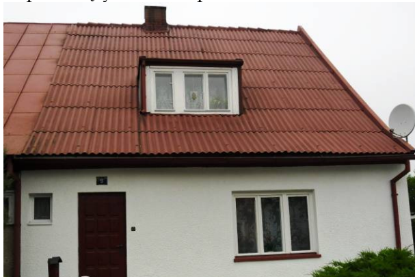
Rys. 10. Pokrycie dachowe ocenione w III stopniu pilności.
