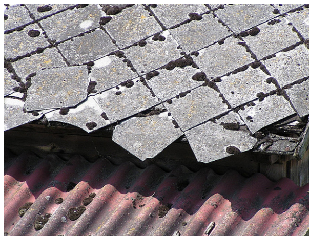
Rys. 12. Pokrycie dachowe ocenione w I stopniu pilności.
