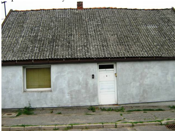
Rys. 11. Pokrycie dachowe ocenione w II stopniu pilności.
