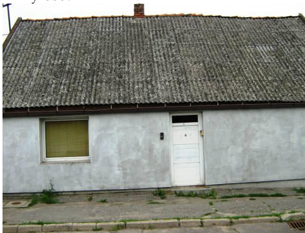
Rys. 11. Pokrycie dachowe ocenione w II stopniu pilności.
