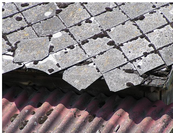
Rys. 12. Pokrycie dachowe ocenione w I stopniu pilności.
