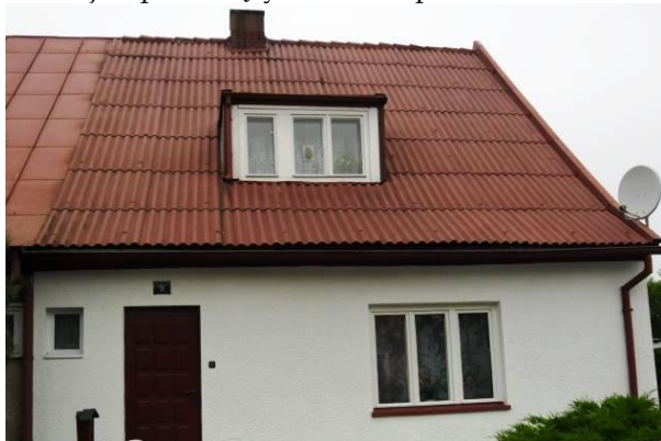
Rys. 10. Pokrycie dachowe ocenione w III stopniu pilności.
